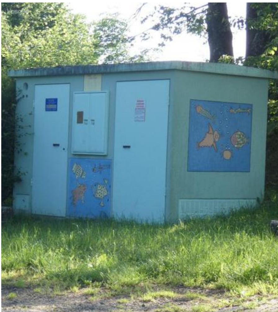
L'installation d'un nouveau transformateur, sur le site des cascades, devrait délester celui de la rue du Lac.
