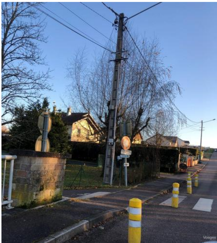
Les pylônes en béton vont prochainement disparaître du paysage route de Renauvoid, avec l'enfouissement des réseaux.
