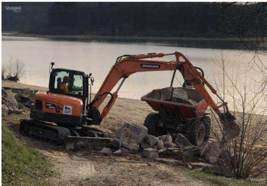
L'opération enrochement se déroule actuellement au bas de l'allée des Roches, à Bouzey.
