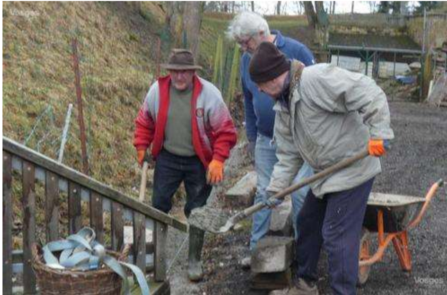
Les couvertines ont été posées sur les murets situés de chaque côté des gradins du théâtre de verdure.
