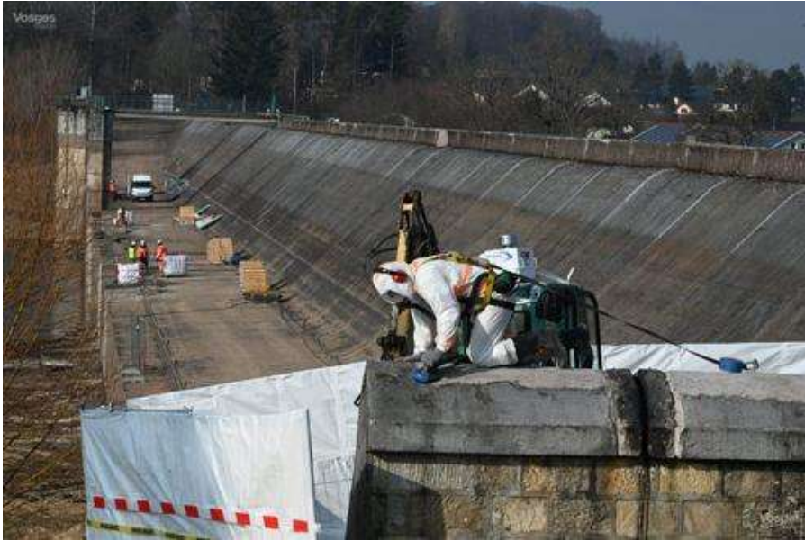
Le chantier de réhabilitation devrait bien s'achever en octobre prochain. Photo VM /Eric THIEBAUT
