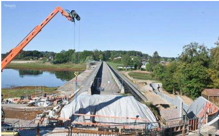
Les lourds travaux sont en voie d'achèvement sur la tête du nouveau bassin d'évacuation de crue entamés à Bouzey. Photo Philippe Briqueleur
