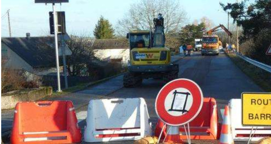
La route de Renauvoid a vu le début des travaux d'amélioration de la chaussée démarrer ce mardi 16 janvier.
