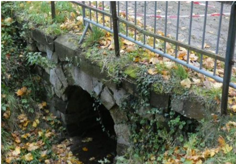
Pierres désolidarisées, rambarde déplacée, le pont des Cascades donne quelques inquiétudes aux riverains.
